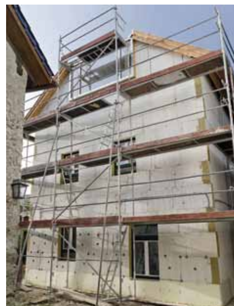
Foto: Tiroler Sanierungspreis 2011
